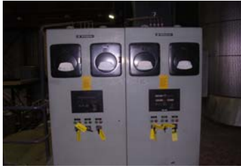
SAN-213 Panel, Switchgear
