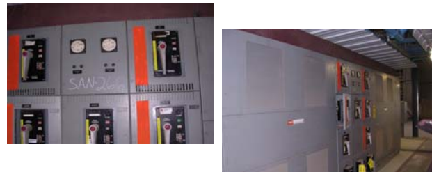
SAN-266 Switchgear Panel
